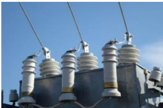
Рис. 5.12 Вид использования ОПН
