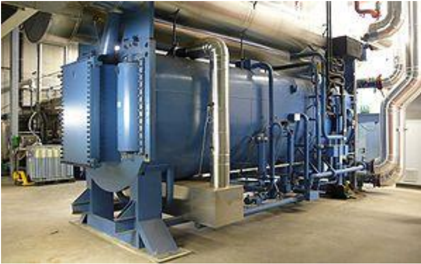
Рис. 5.3. Абсорбционная холодильная машина на 14МВт
