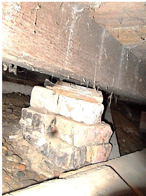
Рис. 8. Оседание кирпичной опоры под лаги пола
