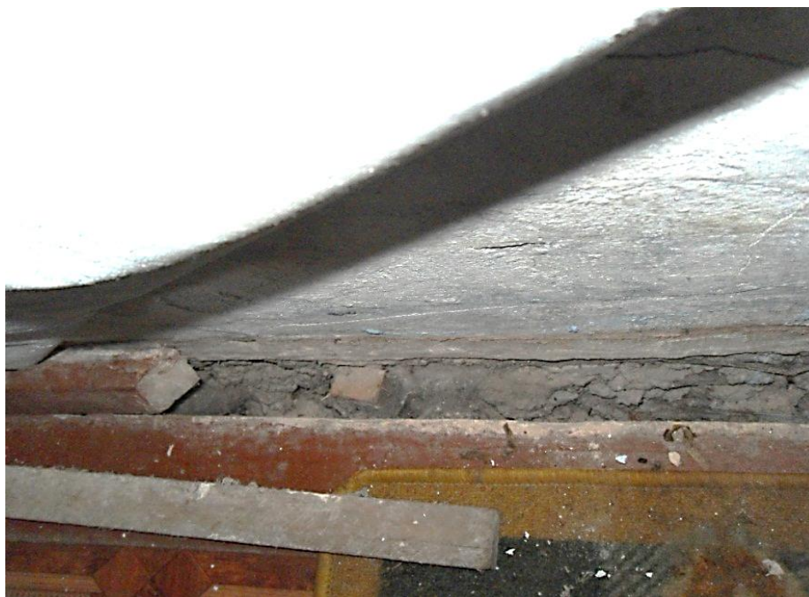
Рис. 7. Щель шириной до 40 мм между досками пола и стеной, идущей вдоль оси Б
