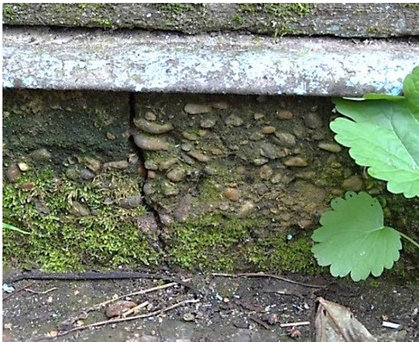
Рис. 4. Вертикальная трещина в фундаменте
