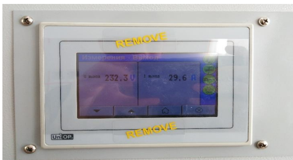
Рис. 9. Сенсорный прибор компании «UniOP» для измерения параметров тока и напряжения на выходах аккумуляторных батарей
