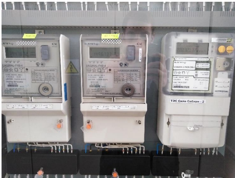
Рис. 8. Цифровые счетчики учета электроэнергии на линиях Короли, АТ-2 220 кВ, ТЭС Сила Сибири – 2 (слева направо)
