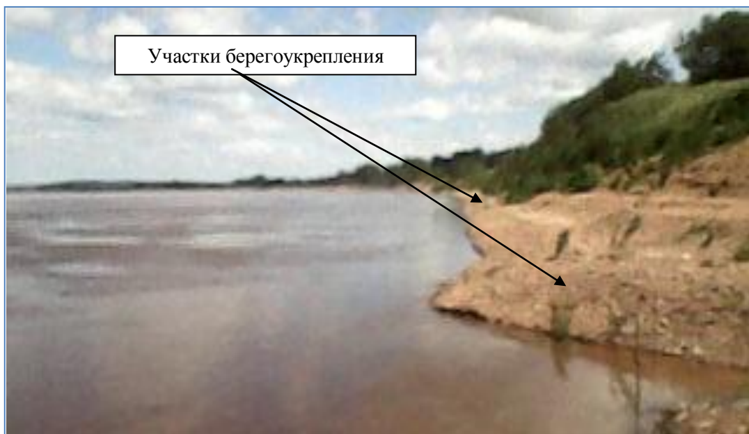
Фото 3. Состояние участка берегоукрепления в районе центрального схода с. Сергеевки после прохождения паводка (август 2013 г.)
