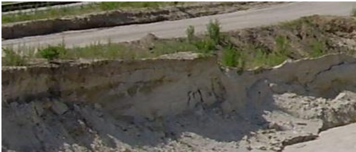
Рис. 1.18. Осыпь вдоль дороги
