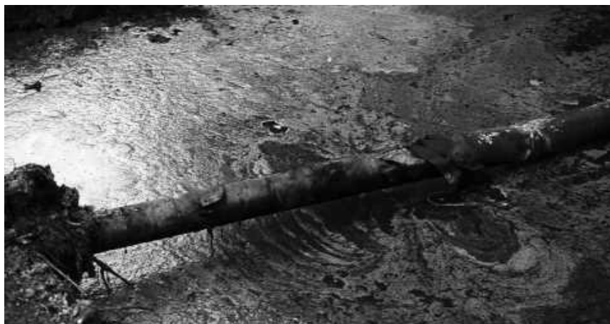
Рис. 2. Прорыв трубопровода в респ. Коми
