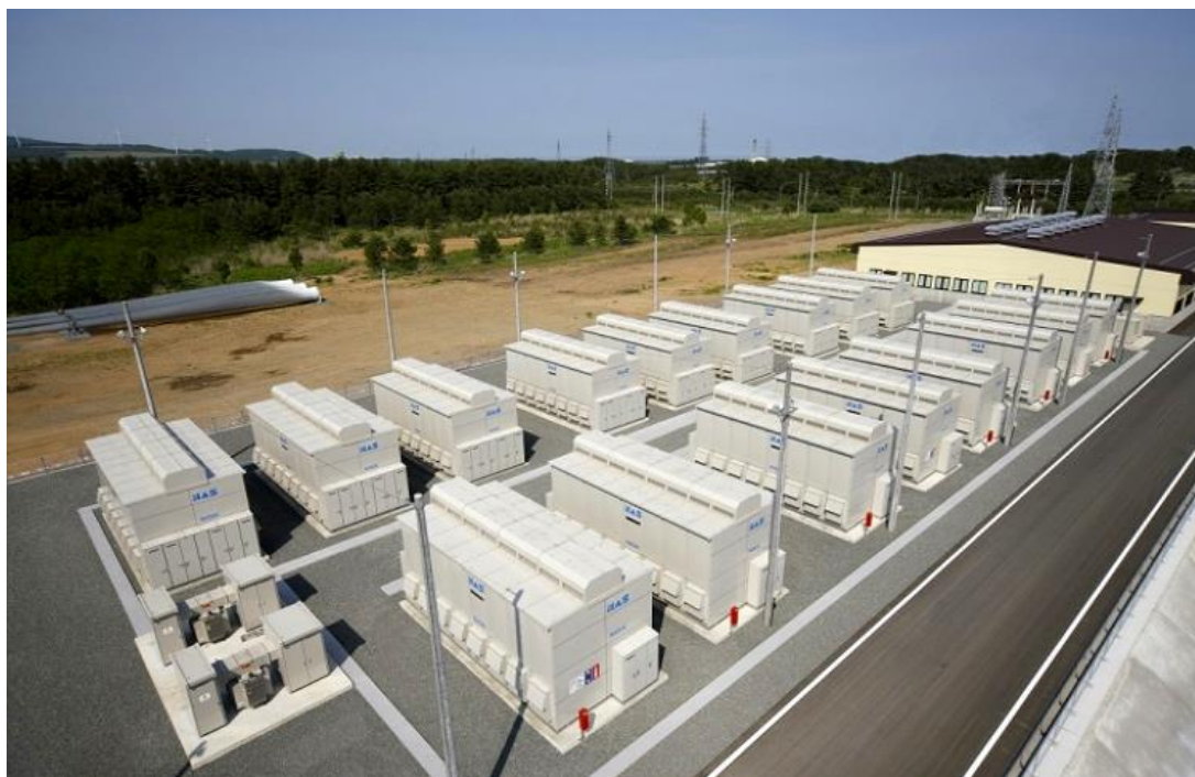
Рис. 2. Одна из 15-ти аккумуляторных систем в столице ОАЭ Абу-Даби, входящая в состав комплекса суммарной мощностью 108 МВт и емкостью 648 МВт·ч
