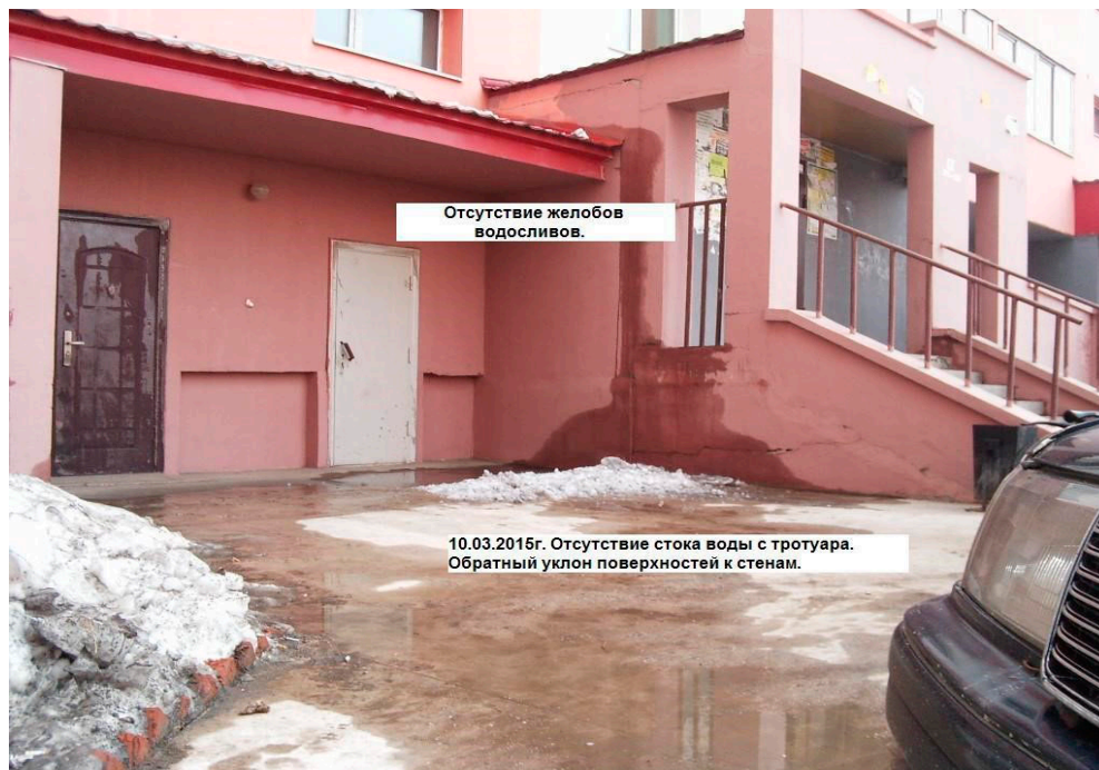
Рисунок 2 – Отсутствие стоков воды с тротуара
