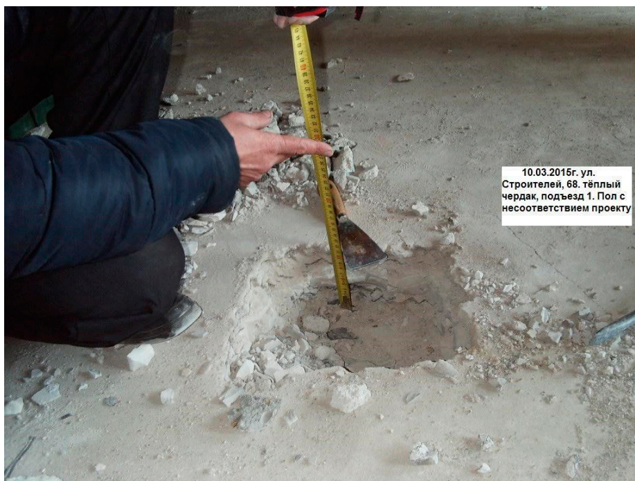
Рисунок 1 – Поверхность пола теплого чердака, не соответствующая проекту
