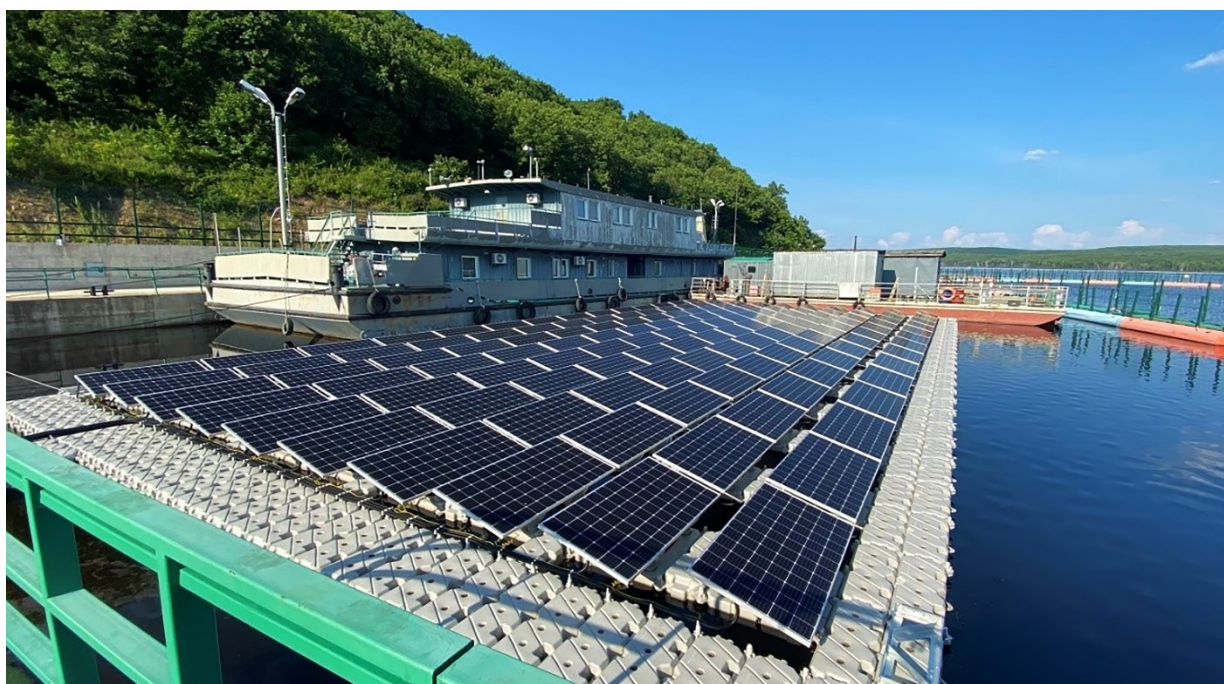
Рисунок 2 – Плавающая солнечная установка на площадке Нижне-Бурейской ГЭС
