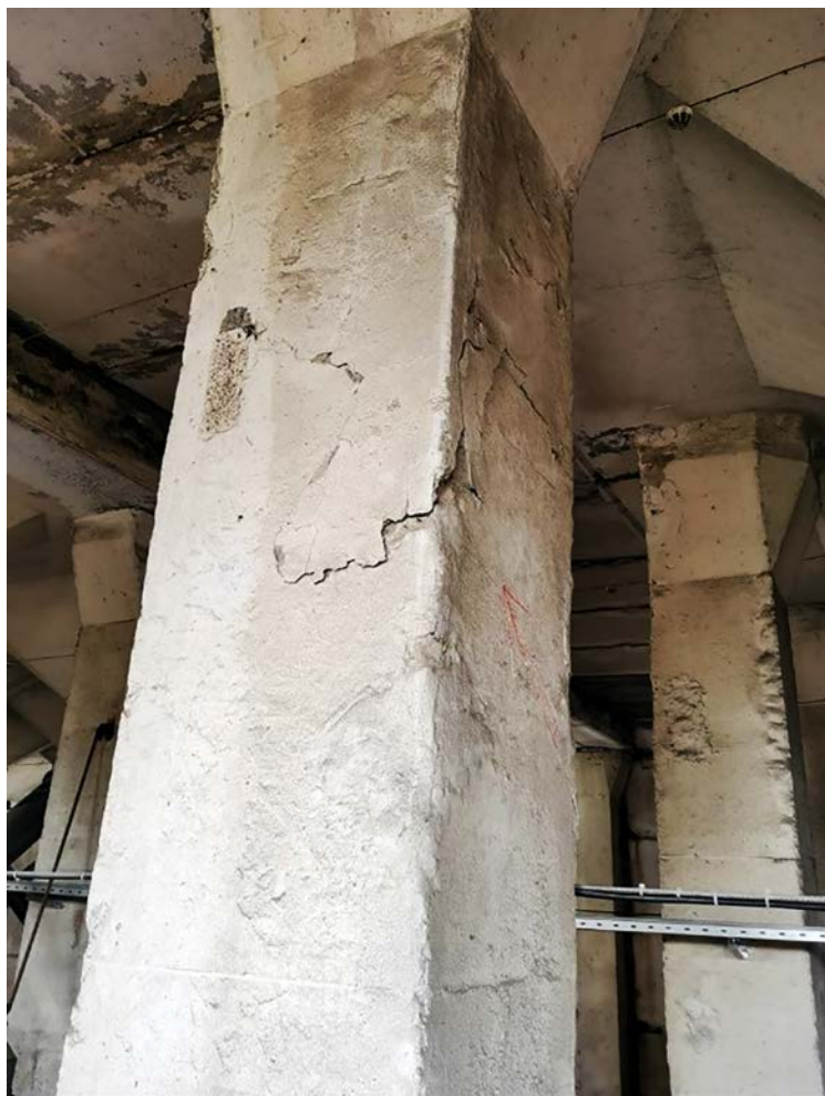
Рисунок 1 – Лещадка в бетоне колонны
