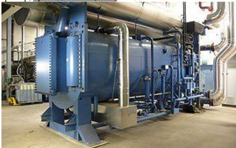
Рис. 5.3 Абсорбционная холодильная машина на 14МВт К абсорбционным холодильным машинам относятся так же аммиачные холодильные установки абсорбционного принципа действия.
