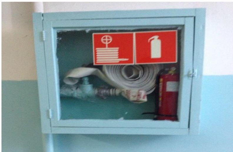
Рис. 1.18 Пожарный кран в здании (Дальневосточный ГАУ, 6 корпус)
