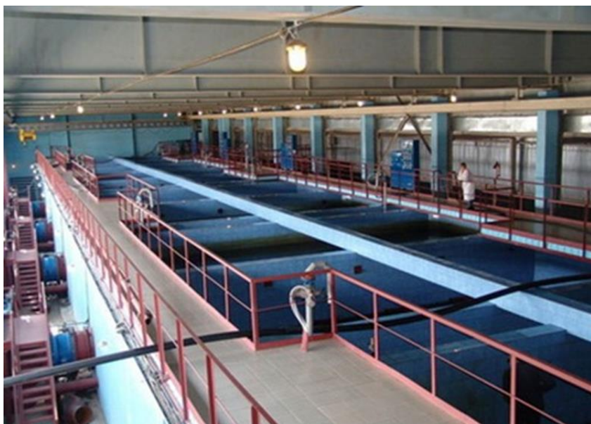
Рис. 1.3. Водоподготовка на Амурском водозаборе
